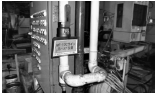
写真4 エア供給停止用ボールバルブ
