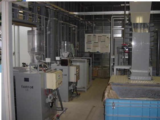
排水処理設備
